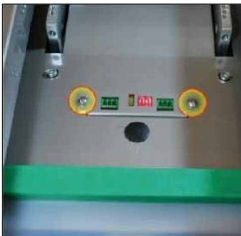
Abbildung 6-7: LED Controller (installiert)
